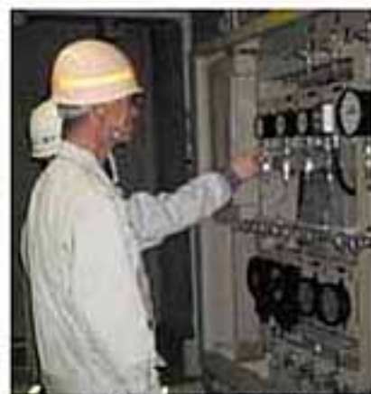
●ダイーゼル発電機（A号機）の試験の様子
