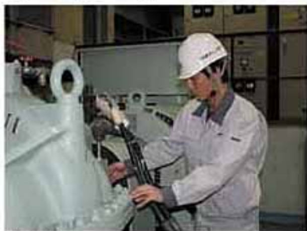
●巡回点検 モーターのカバーに降りて、振動や熱などを確認します。目だけでなく、五感を使って異常を検知します。
